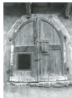
Giebelseitiges Sandsteinportal mit zweiflügeligem Bretttertor und dekorativem Riegelschloss. Zustand vor der Restaurierung, Juni 1995. Fotoarchiv HBA.
